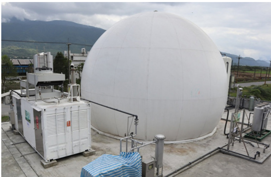
圖 5 沼氣發電廠設施
